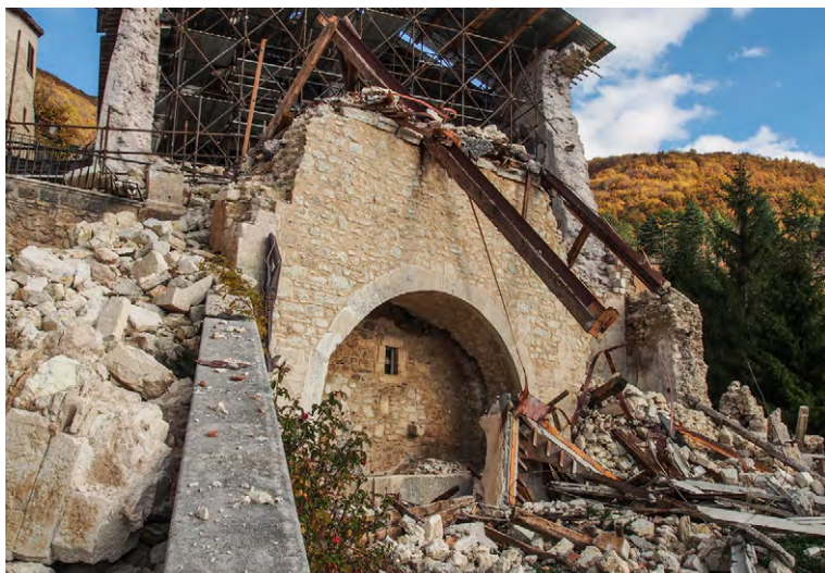
Nosné zdi poškozené zemětřesením, Itálie, 2017.
