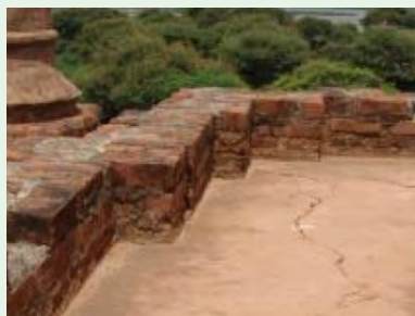
Trhliny ve střeše chrámu, Bagan, Myanmar, 2016. Foto: Eugénie Crété.
